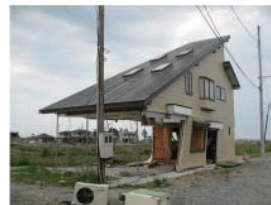
福島県新地町(津波被害)
