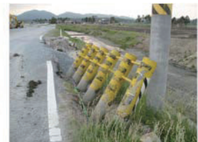
福島県新地町(津波と道路の陥没)
