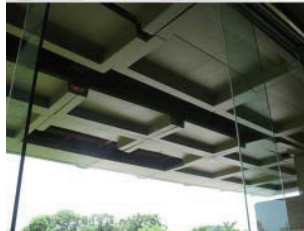
PC(プレキャストコンクリート)の落下 (福島県立)
