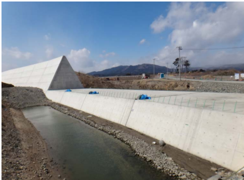
写真7 気仙沼市階上地区波路上杉ノ下で建設中の防潮堤。震災時の杉の下は人口294人、死亡93人。階上地区では、全壊1,746戸、半壊・損壊922戸、計2,668戸。波路上杉の下地区の住宅再建は5世帯のみ。2019年3月、筆者撮影。
