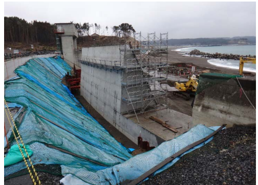
写真8 岩手県九戸郡野田村、三陸復興国立公園（陸中海岸国立公園）十府ヶ浦海岸、国道45号沿いの堤高13.8mの防潮堤工事。4kmの海水浴場の砂浜、ハマナス群生は、建設工事現場に変貌した。2017年3月25日、三陸鉄道北リアス線の新駅「十府ヶ浦海岸駅」開業直後、2017年4月1日、筆者撮影。
