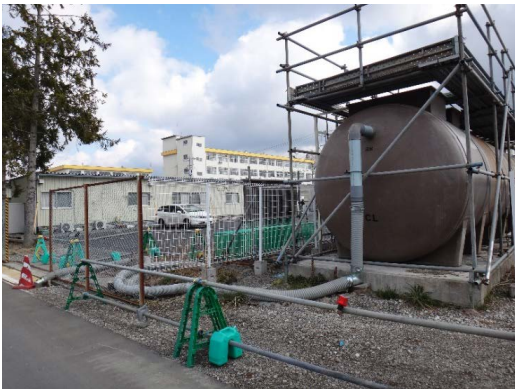
写真3 宮城県気仙沼市田中前、気仙沼市立条南中学校の校舎、校庭の応急仮設住宅団、地水処理浄化水槽（嫌気ろ床接触曝気方式）。気仙沼市の気仙沼中学校、条南中学校、松岩中学校、水梨小学校、階上中学校、面瀬中学校、小泉中学校、大谷中学校の応急仮設住宅は、2017年10月から解体し2018年3月までに撤去完了。2017年4月2日、筆者撮影。
