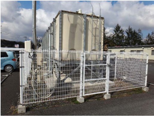
写真2 宮城県気仙沼市立条南中学校校庭の仮設住宅（応急建設住宅）用の上水道多層式水槽。三菱樹脂2011年7月製造、長さ10m、幅・高さ2m、水道法34条の簡易専用水道を供給。右奥の応急プレハブ仮設住宅は、長屋式で12棟、1棟当たり5戸から7戸が入居する。2017年4月2日、筆者撮影。2018年3月には、応急仮設住宅も衛生施設も撤去され、中学校の校庭復旧作業中だった。
