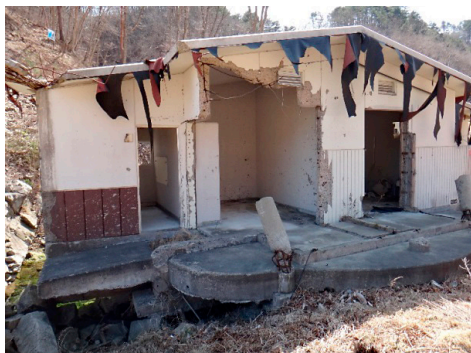
写真28 岩手県宮古市崎山の三陸復興国立公園・震災遺構「震災メモリアルパーク中の浜」：2011年3月11日、高さ15mの津波が中の浜のキャンプ場コンクリート製トイレ施設、周囲の林を破壊した。2018年3月31日、筆者撮影。
