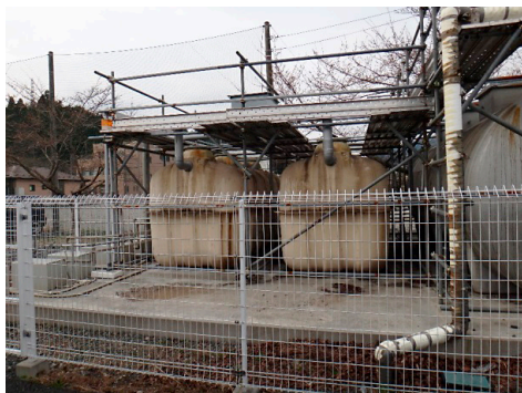
写真11 気仙沼市反松公園の応急仮設住宅用の下水処理浄化水槽。嫌気ろ床接触曝気方式で、水槽に空気を送り微生物を繁殖させて汚物を分解、沈殿させる。排水は消毒槽に送られる。反松公園の仮設住宅団地は、2019年に撤去予定とされている。2018年4月1日、筆者撮影。
