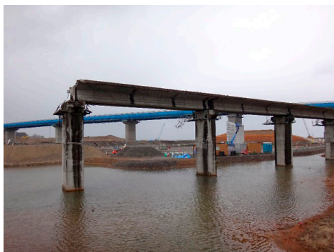
写真1 宮城県気仙沼市本吉町、東日本旅客鉄道気仙沼線の陸前小泉駅付近の高架残骸。後方では盛り土により高台が整備途上。JR東日本は、震災を契機に赤字路線の廃線を本格化し、2012年8月、線路を専用道路としたバス高速輸送システム（BRT）を採用。北の三陸鉄道は復旧の予定で、鉄道輸送に不整合が生じている。後方は、高架化工事中の国道45号線。近くの気仙沼市立小泉小学校は、仮設住宅の撤去とともに通学者は減少し、2018年4月現在、全校児童50名、教職員13名。2017年3月27日、筆者撮影。
