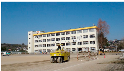
写真8 気仙沼市立条南中学校の校庭にあった応急仮設プレハブ住宅撤去作業の最終段階。住宅を撤去して、整地作業をしている。撤去対象の19団地を既存の23の拠点団地に集約したが、再建による退去完了後解体する予定となっている団地は50団地もある。2018年3月28日、筆者撮影。
