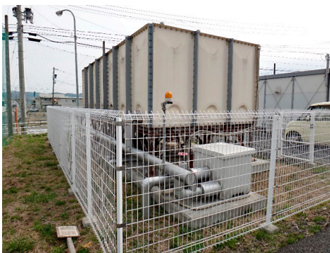
写真10 気仙沼市反松公園の応急仮設住宅用の上水道多層式水槽。プリヂストン2011年5月製造。縦3m、横7m、高さ2mの容積がある。右奥は、応急プレハブ仮設住宅で、どの団地にも上下水道の簡易施設（水槽式）が設けられている。2018年4月1日、筆者撮影。
