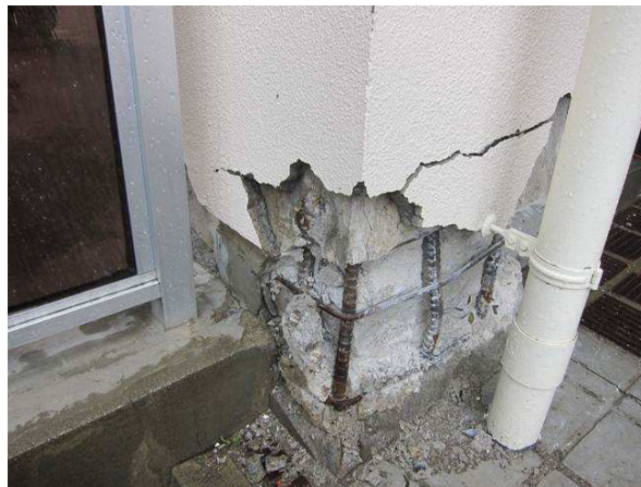
写真1 損傷度Ⅴの柱
