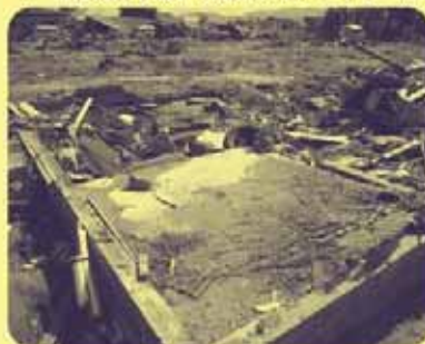
▼ 土台だけを残して流出した、デイホーム
