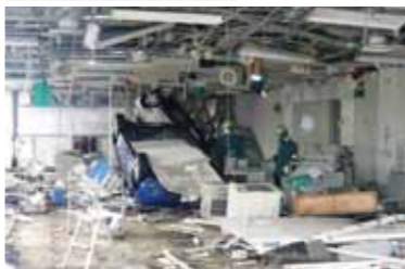
港工場の被害状況
