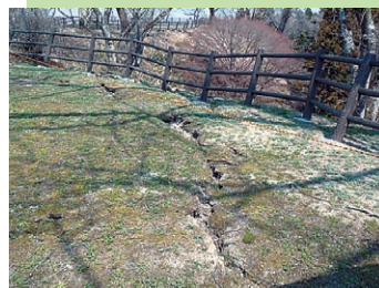
写真上: 園路に落石 下: 曲輪の亀裂
