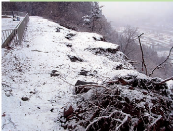
写真上: 本丸西側石垣の崩落 (史跡外) 下: 本丸跡崖地の亀裂
