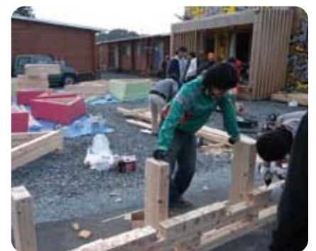
三角形に組み立てられているのは塔の部材、右奥に見えるのはペインティングが施された仮設集会所、手前はベンチ製作を行う学生さん。
