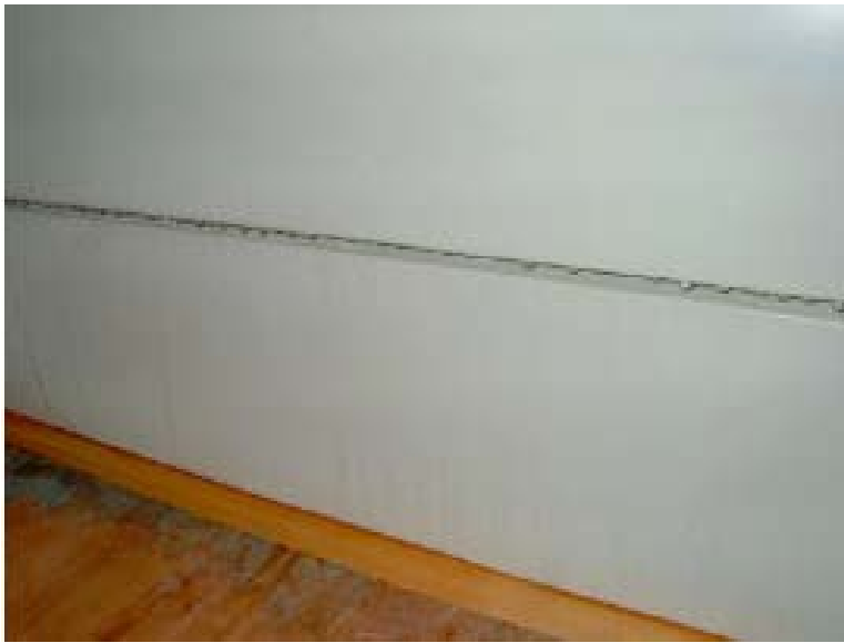
壁一面の結露で床にはカビが
