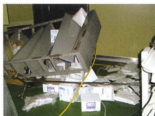
器材が散乱した手術部内の様子
