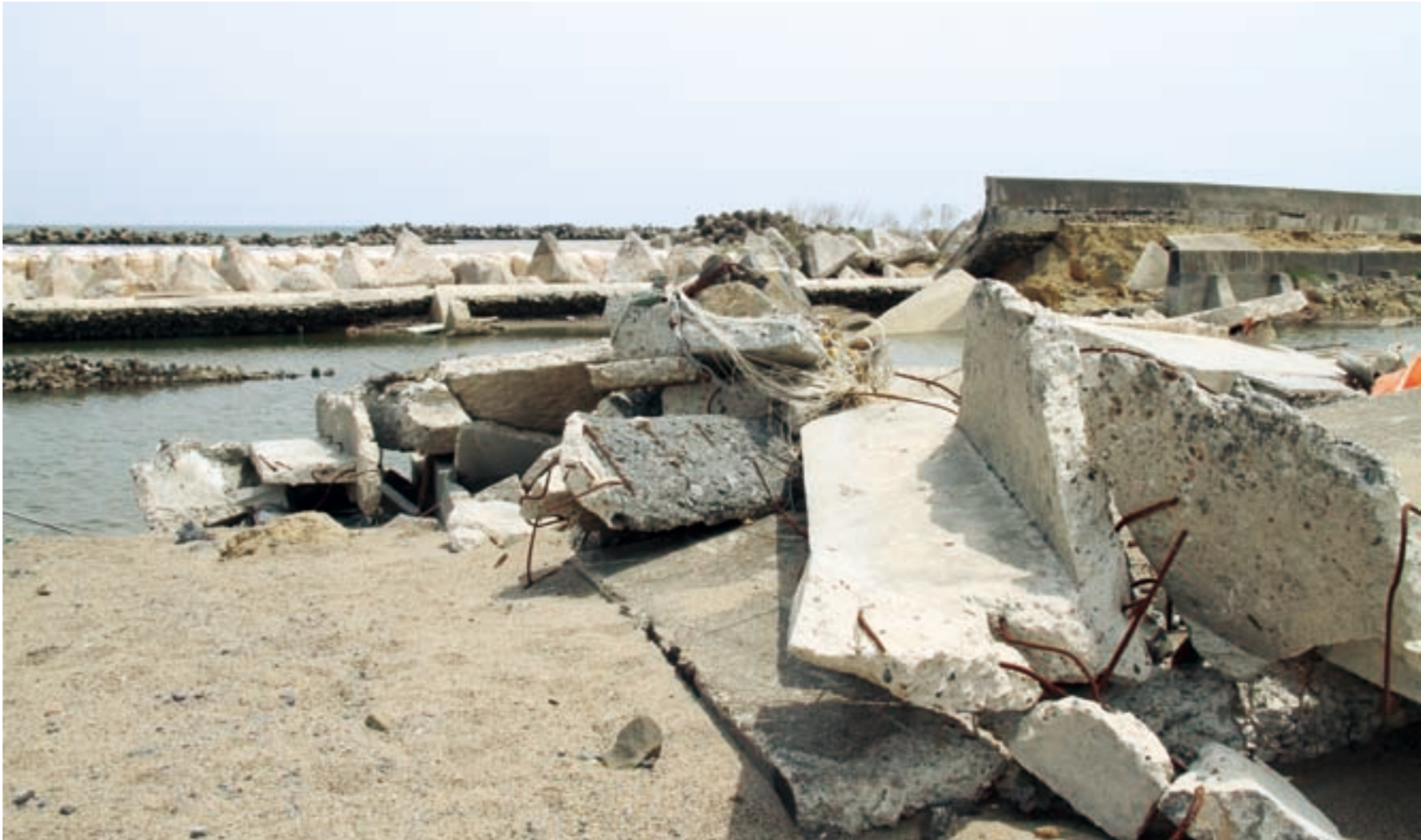
津波によって粉々に破壊された荒浜五丁目の堤防
