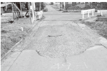
▲長岡クリーンセンターは被害がありませんでしたが、道路が液状化し、マンホールが隆起
