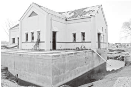
▲全壊した相野釜クリーンセンター
