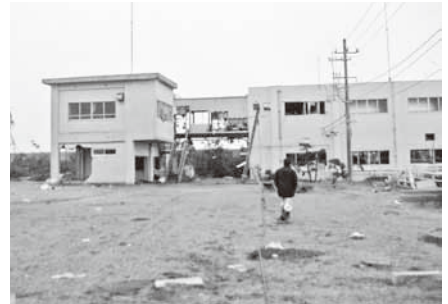
▲津波が2階まで押し寄せ、甚大な被害を受けた二の倉排水場
