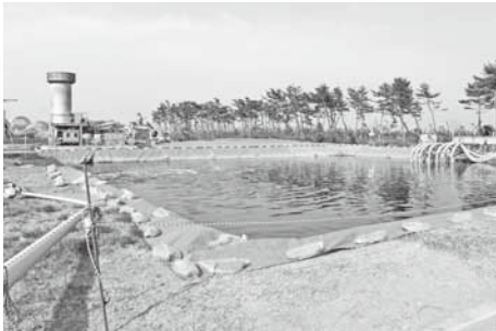
▲仮復旧をし、下水の上澄みを塩素で消毒し、海へ放流しています（県南浄化センター）
