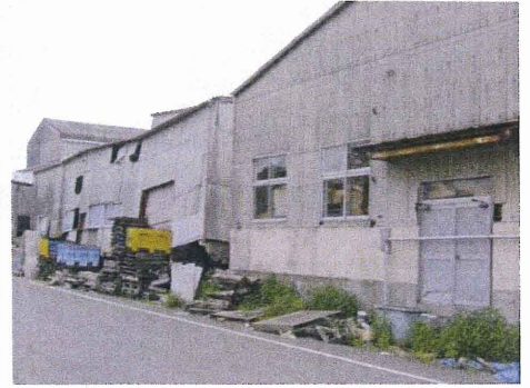
▲水産加工団地では地盤が液状化
